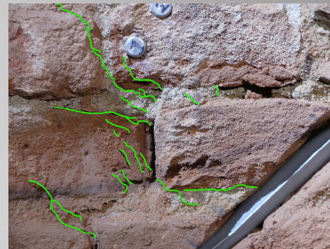
Dettaglio della fessurazione della muratura al termine della prova
